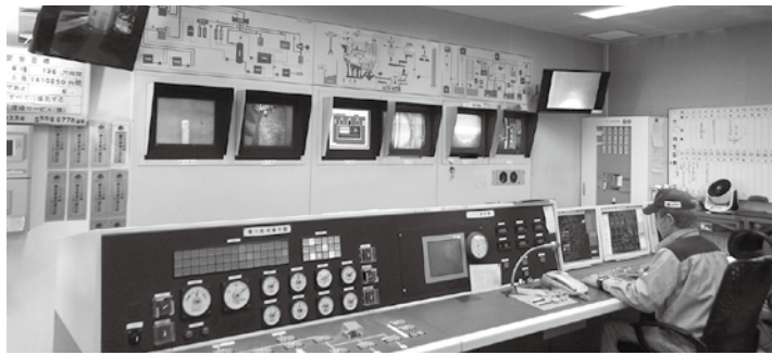
印西クリーンセンター中央制御室
