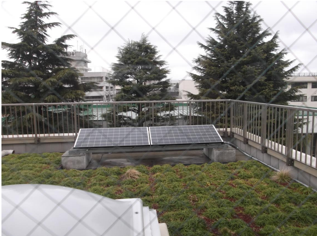
⑤ 3階屋外部（主な太陽光発電パネルは屋上に設置しています）※奥は三鷹市役所
